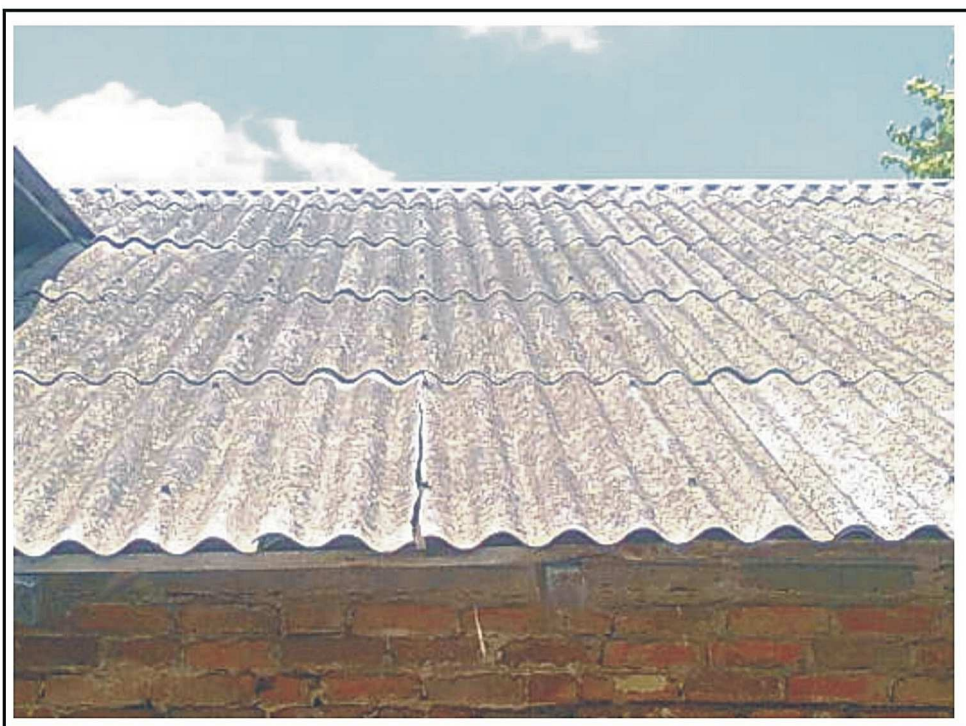
Fot.2 Pokrycie dachowe budynku mieszkalnego z płyt falistych - II stopień pilności
