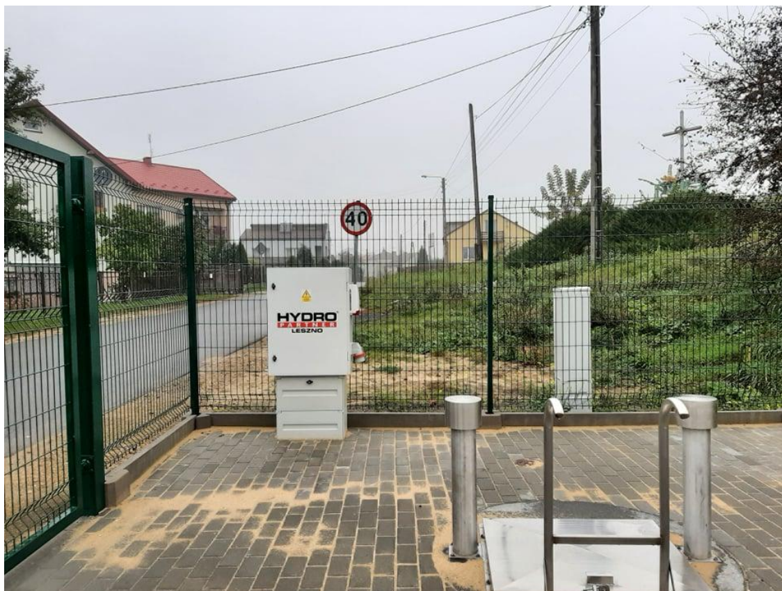
Zdjęcie 14 Przepompownia ścieków wykonana w ramach II etapu budowy kanalizacji sanitarnej
