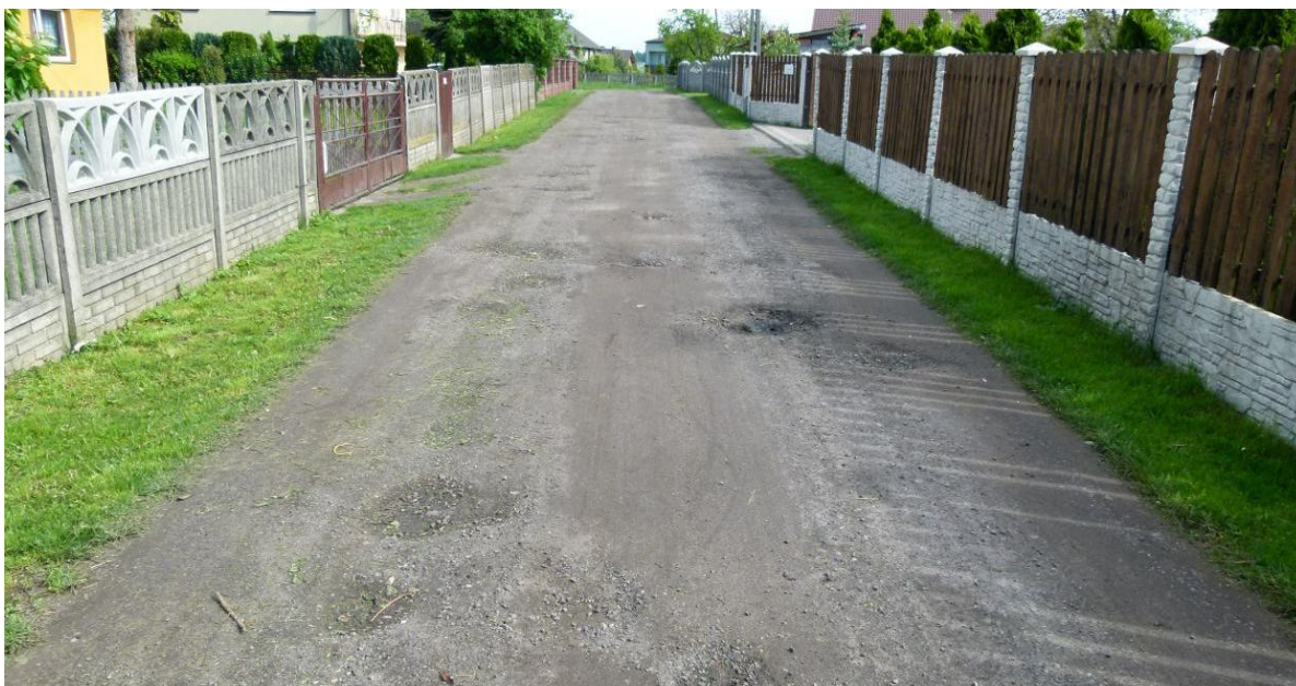
Zdjęcie 15 Gołuchowice- stan drogi przed przebudową
