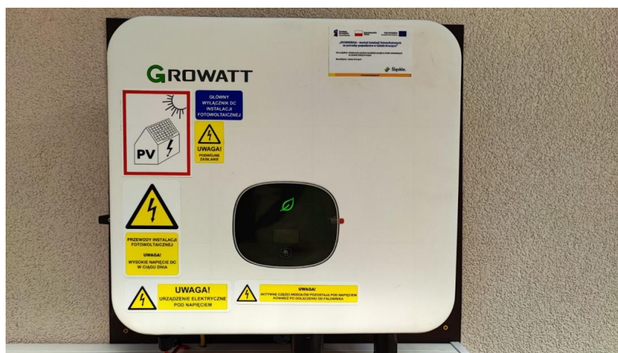
Zdjęcie 31 Inwerter instalacji fotowoltaicznej wykonanej w ramach projektu
